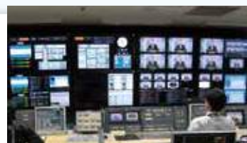
放送運行の中枢である主調整室と監視制御卓
